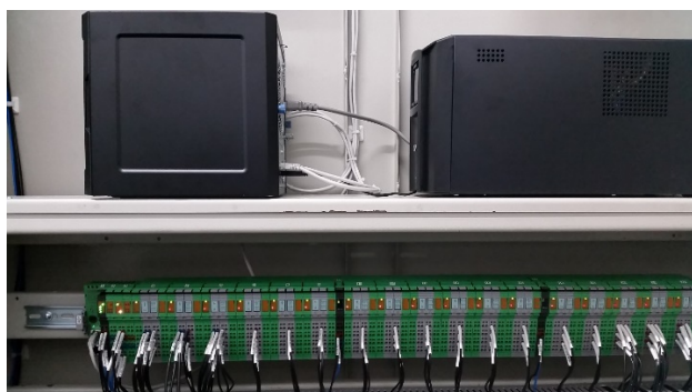
HTTP server a hlavní controller (PLC)
